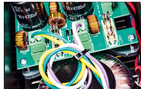
Die Netzteilsektion ist auf einer schwingenden Basisplatte aufgesetzt
